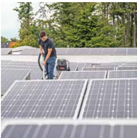
R18 D Reiniging tussen fotovoltaïsche systemen
